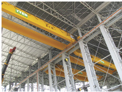
• DOUBLE GIRDER E.O.T CRANE
